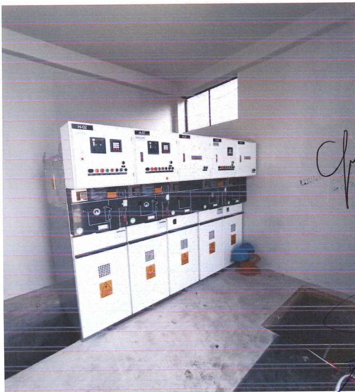
IMAGEN N°28: INSTALACIONES DE SUBESTACION ELECTRICA N°14
